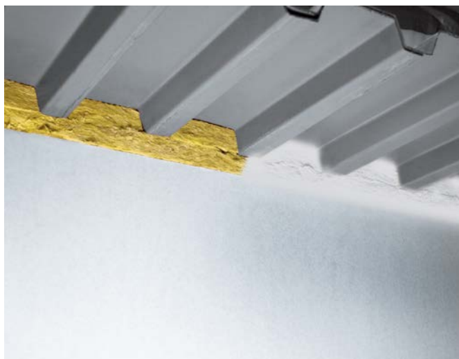
Stavební spára pod stropní konstrukcí EI 120 min
